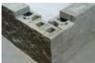
Knäckning av toppsten i hörn
